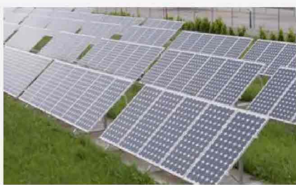
Un impianto fotovoltaico in Puglia
